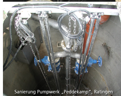
Beispiele für Betonkorrosion
